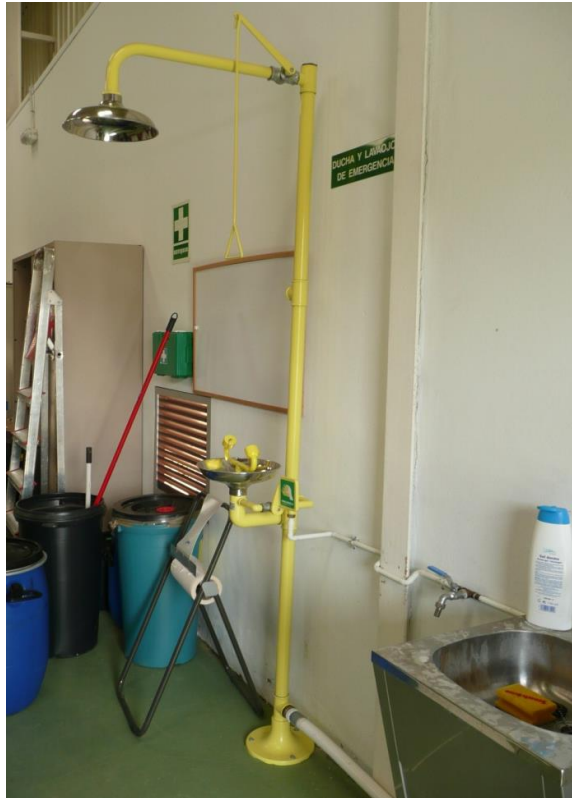
Ducha y lavado de emergencia ante posibles accidentes
