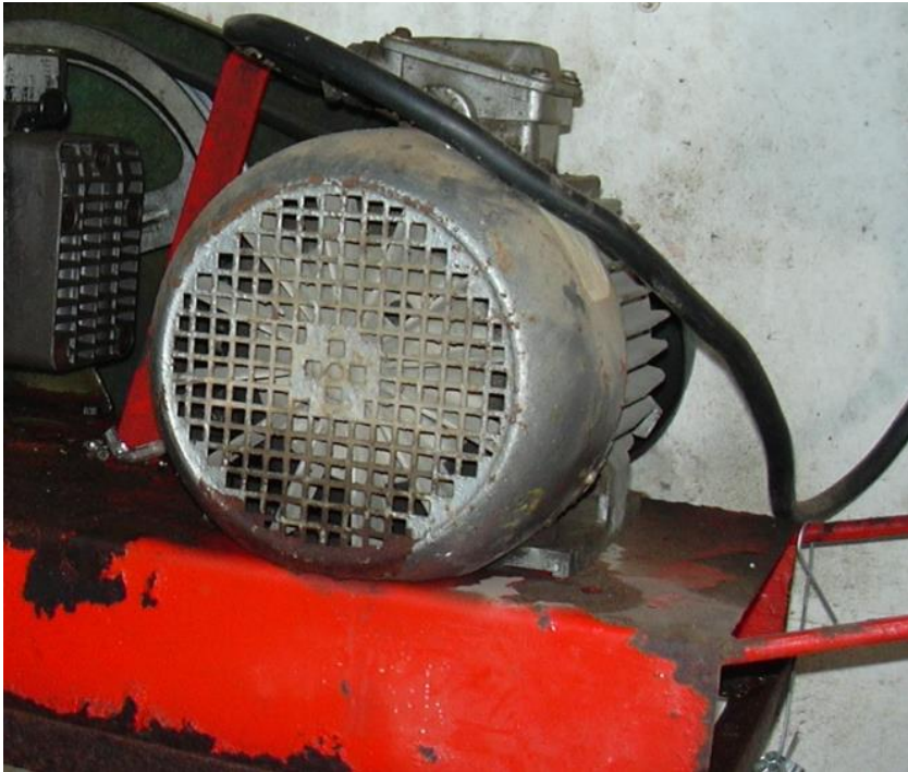
Tubería de impulsión de un sistema fijo de pulverización que puede deteriorarse por abrasión al contacto con el motor
