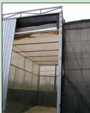
5. Dobles puertas en invernadero
