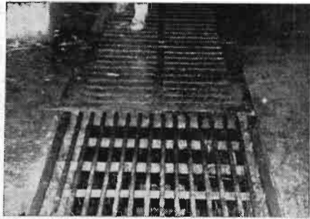
Fig. 9. — Al fondo, parrilla de cemento. En primer término, una de hierro. Las medidas deben estar bien calculadas, para que no se produzcan lesiones.
